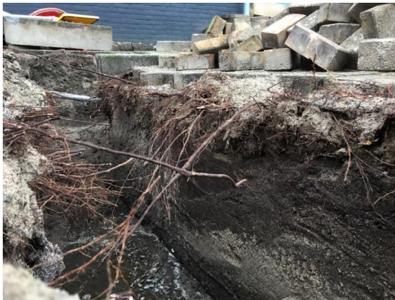
Veel wortelbeschadiging bij graafwerkzaamheden.
