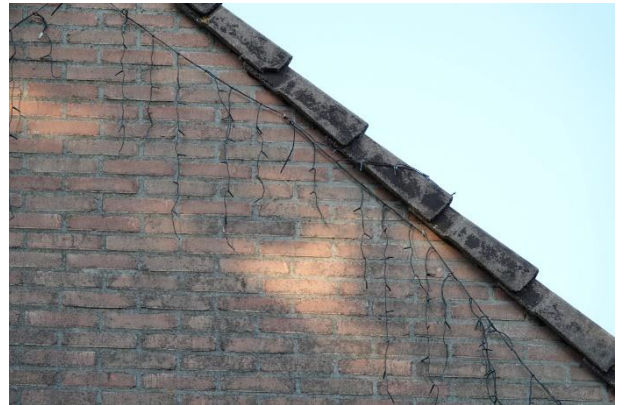
Tegen de gevel hangende verlichting of ander verstorend materiaal.
