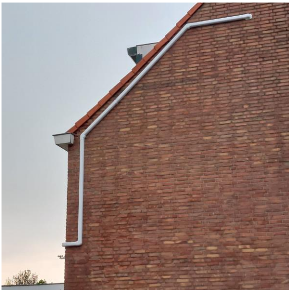
Foto 8. Door de aanleg van deze leidingen recht onder de kantpannen zijn deze ongeschikt geworden voor gierzwaluwen om in te vliegen.
